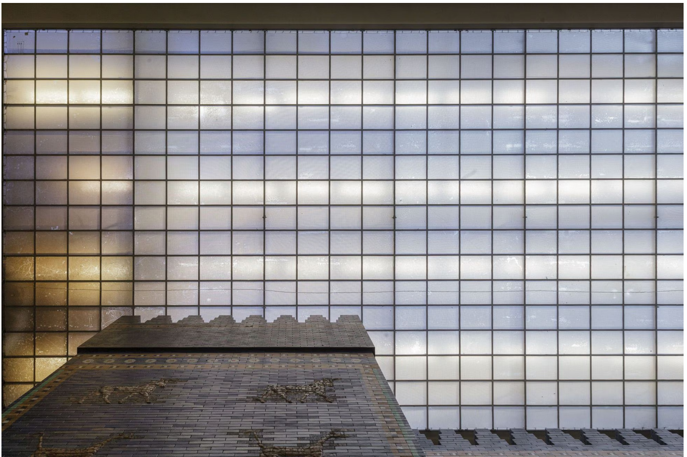
Numerosos cristales del techo luminoso -aquí sobre la puerta de Ishtar- están defectuosos o muy sucios. Esto perjudica la iluminación natural de los objetos expuestos. Unas redes impiden que se caigan los cristales desprendidos.
